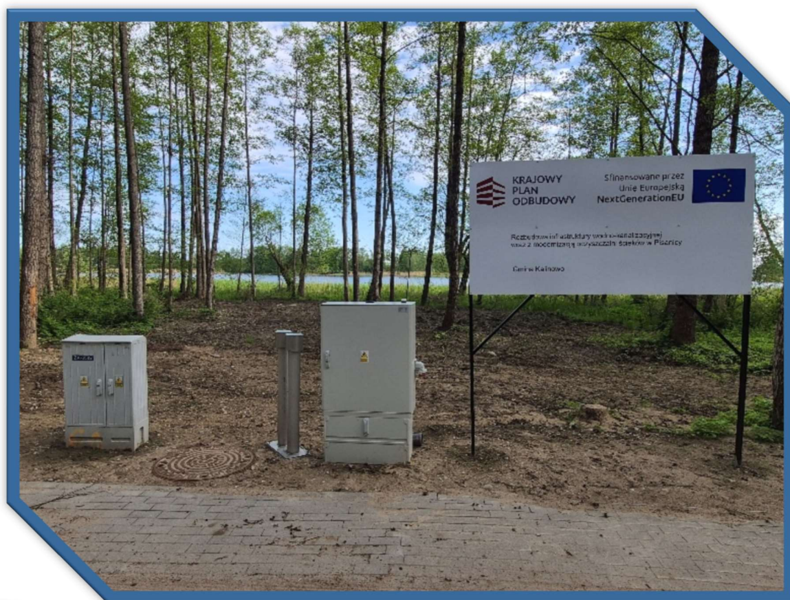
Najazdowa przepompownię ścieków - Makosieje
