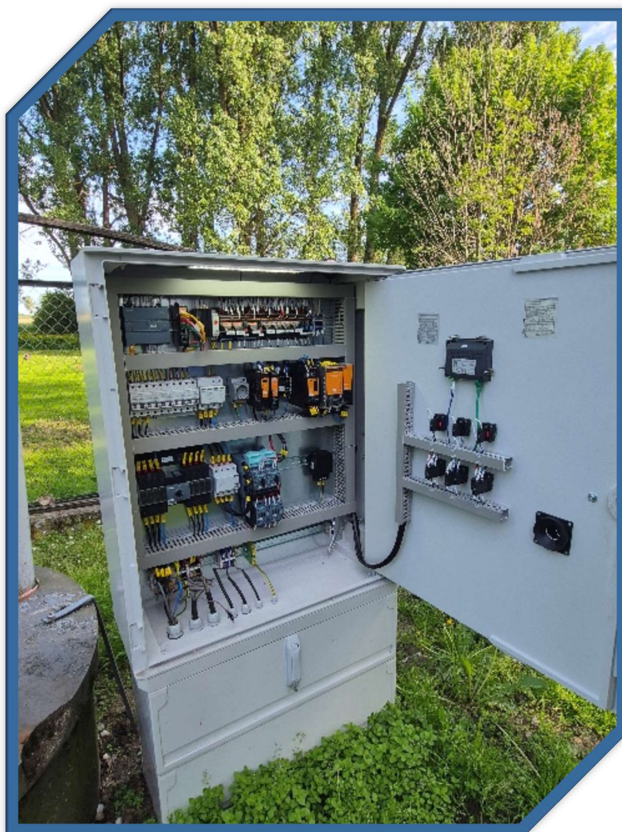
Rozdzielnica sterująca z układem sterowania modernizowanej przepompowni ścieków SP2 w Pisanicy
